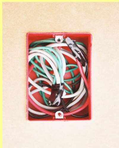
Caixa repleta de fios
