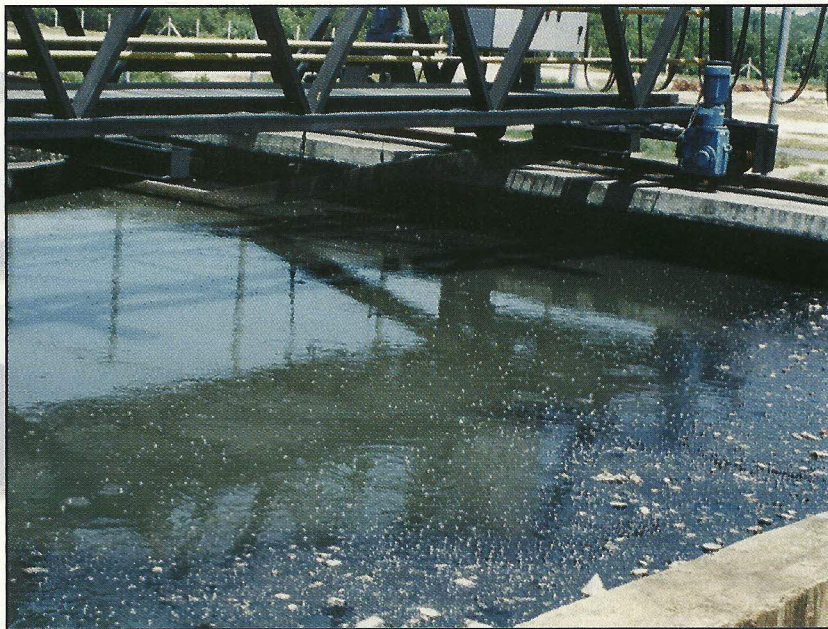
Problemas importantes como o do tratamento de esgotos vêm sendo adiados
