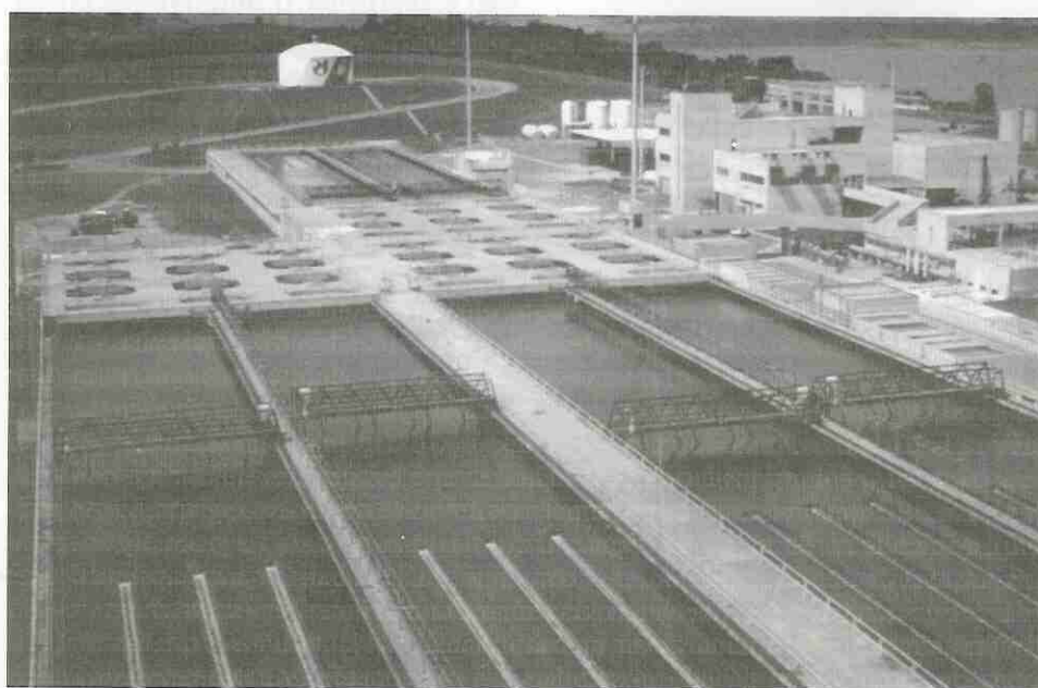
A Estação de Tratamento de Água de Taiacupeba, do Sistema Alto Tietê, foi ampliada de 5 mil para 10 mil litros/seg.
