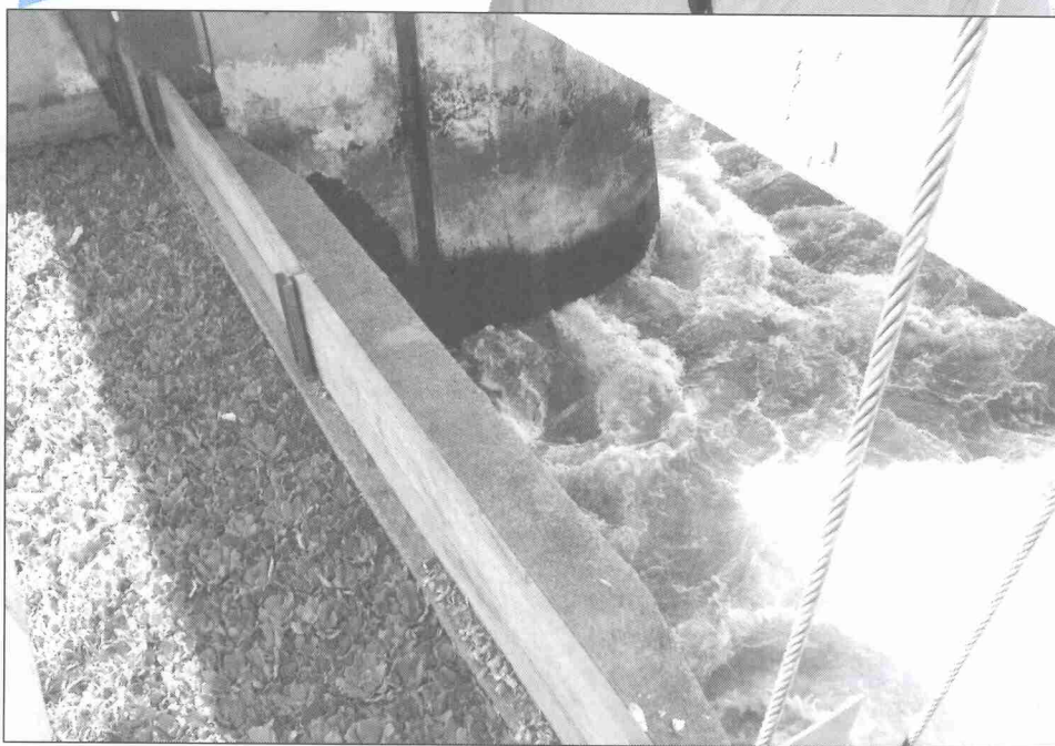
As comportas das barragens do sistema de captação de água bruta receberam pranchões de madeira para elevar o nível do Guandu e reduzir a influência dos rios Poços, Queimados e Ipiranga
